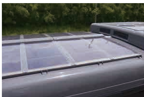
ソーラーパネル Solar PV panels
