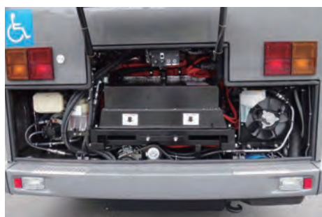
エンジンルーム内 Engine room
